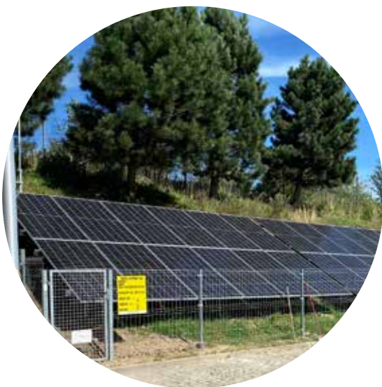
Kompleks Aqua Zdrój instalacja fotowoltaiczna
