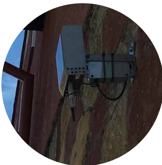
Instalacja pyłomierza monitorowanie zanieczyszczeń
